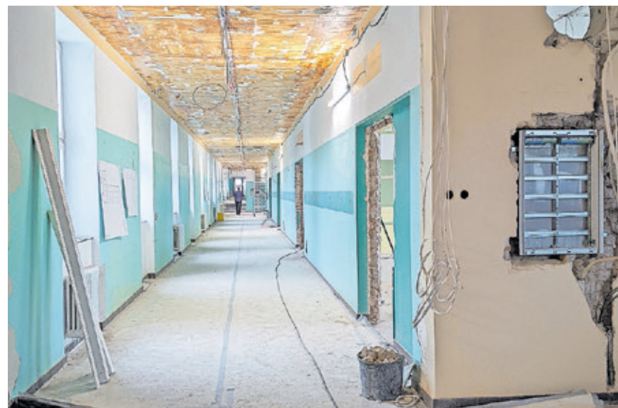
Arbeiten zur Innensanierung in der Grundschule am Geisberg in Bischmisheim. Foto: Landeshauptstadt Saarbrücken
